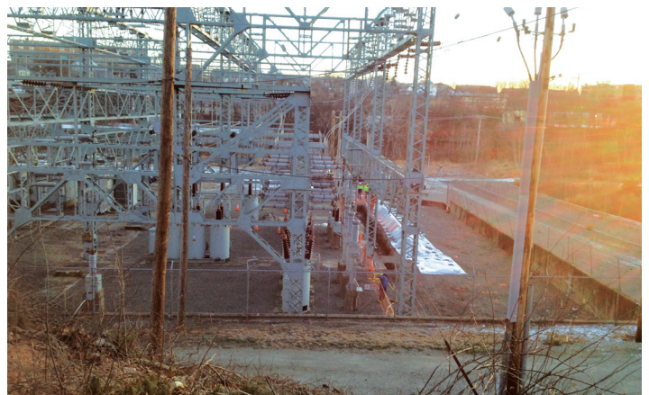
A maior parte das escavações associadas à atualização da subestação elétrica existente de Tidewater está concluída.
